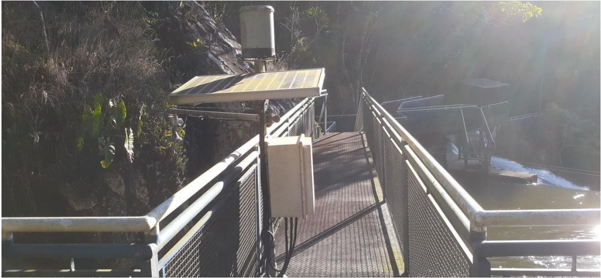
Figura 53: Estação hidrológica do CEMADEN instalada na tomada d'água da Mineração Corrêa.
