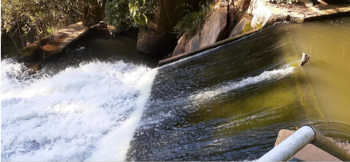
Figura 49: Vertedouro na captação da Mineração Corrêa.
